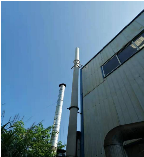
抛丸、喷漆（活性炭）排气筒加高到 15m
