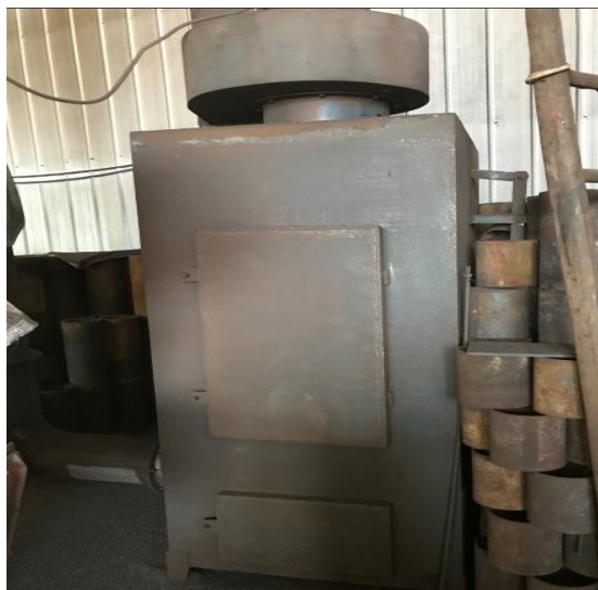
布袋除尘器（抛丸及喷砂）
